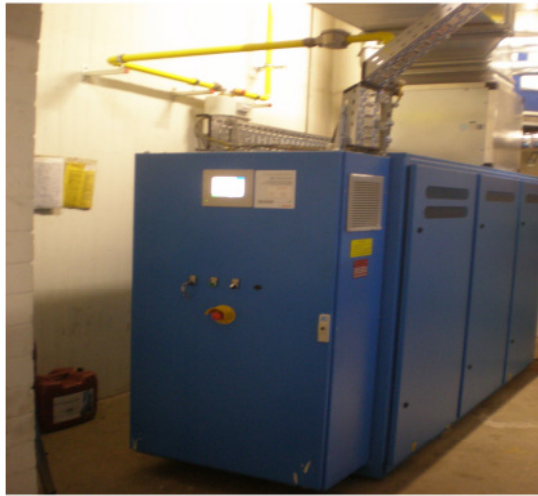
Abbildung 28: BHKW im Kreishaus Lüdenscheld
